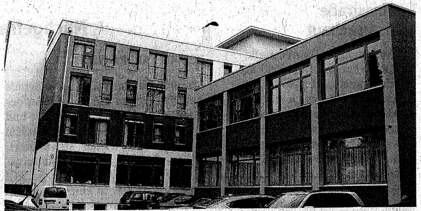
Der Osttrakt mit dem neuen Penthouse und der Funktionsbau des Lebenszentrums Ottobeuren wurden grundlegend saniert. Foto: Unglert-Meyer
